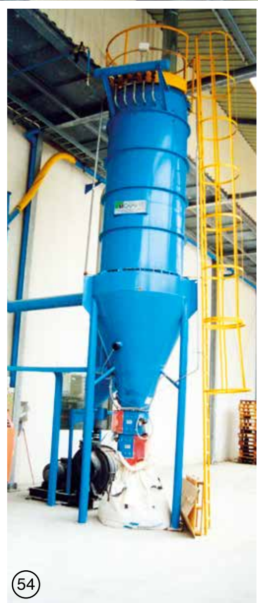
Impianto aspirazione supero / Vacuum cleaning system
