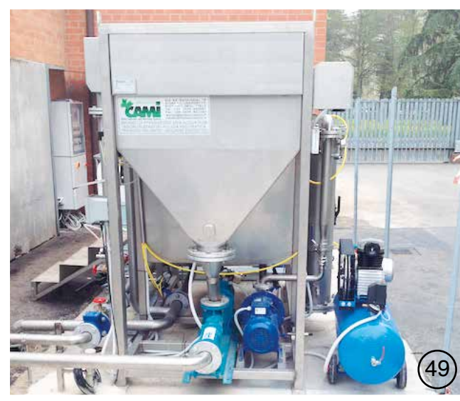
Bio reattore / Bio-reactor
