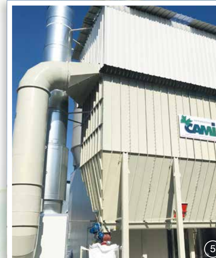
Impianto di aspirazione polveri / De-dusting system
