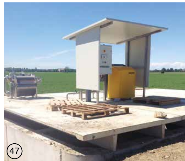
Impianto SBR / SBR System
