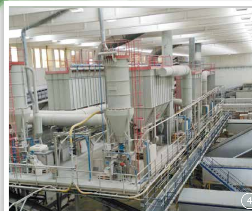
Impianti di aspirazione polveri e trasporti pneumatici De-dusting systems and pneumatic transports
