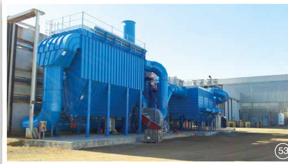
Filtro a maniche autopulenti con batteria di silos con carboni attivi / Bag filter unit and battery of carbon
