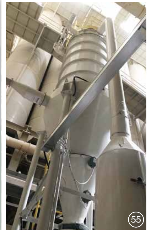
Impianto aspirazione supero / Vacuum cleaning system
