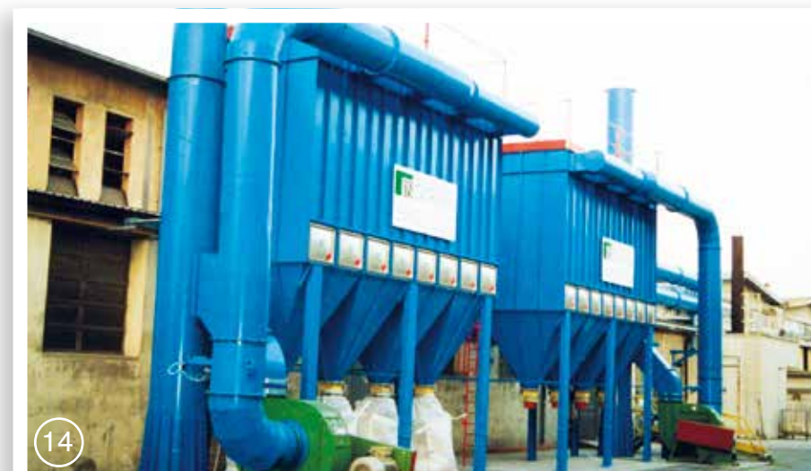
Impianto di aspirazione a norme ATEX / De-dusting system
