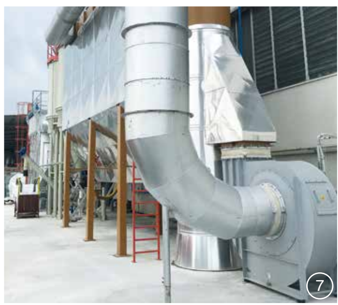
Impianto di filtrazione fumi / Fumes filter
