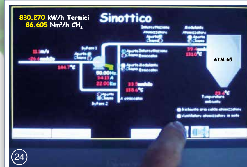
Sinottico recupero energetico / Energy recovery control panel
