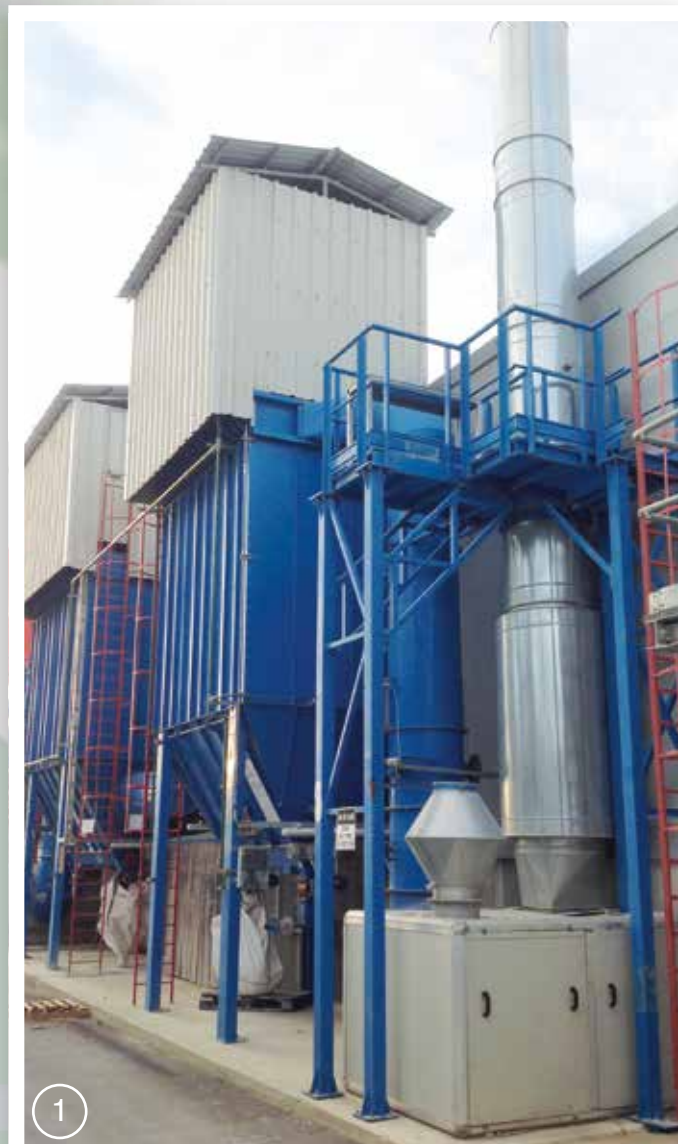
Impianto di aspirazione polveri / De-dusting system
