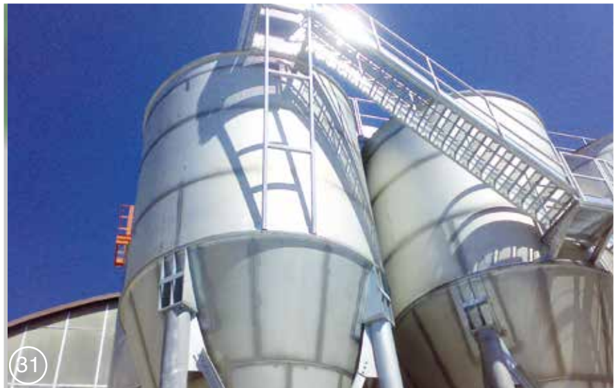
Vasche di sedimentazione / Sedimentation tanks
