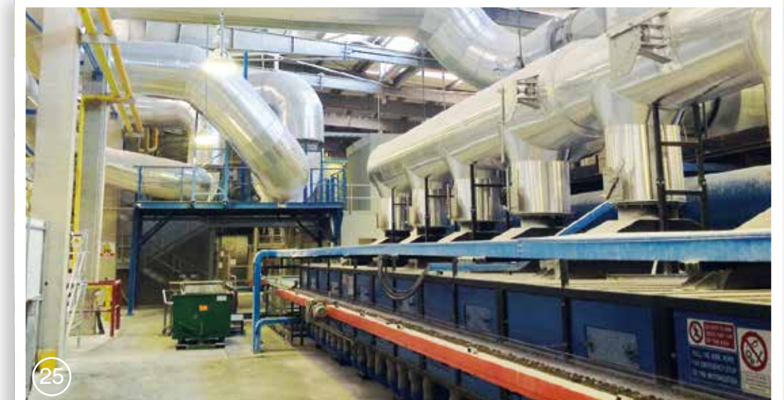
Sistemi di recupero da cascami termici zona raffreddamenti forno Heat recovery systems from waste heat in the kiln's cooling area
