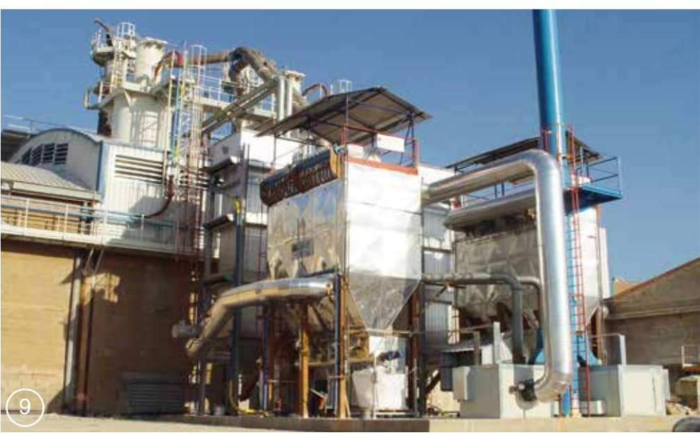
Impianto di filtrazione fumi con scambiatori autopulenti / Fumes filter and auto self cleaning heat exchanger
