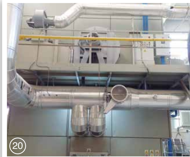
Recupero termico su essiccatoio verticale Heat recovery on vertical dryer
