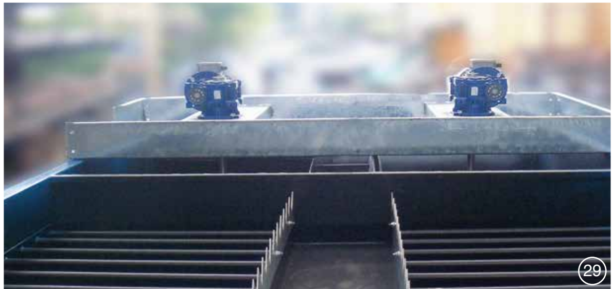
Sedimentatore lamellare / Lamellar settler
