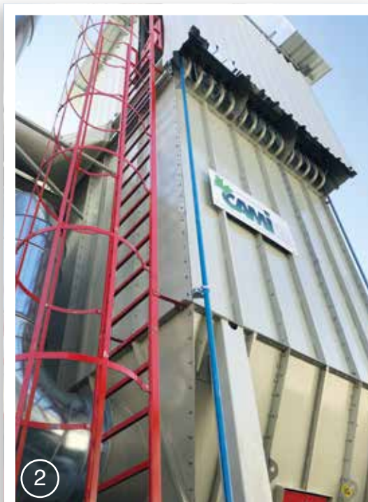
Impianto di aspirazione polveri / De-dusting system
