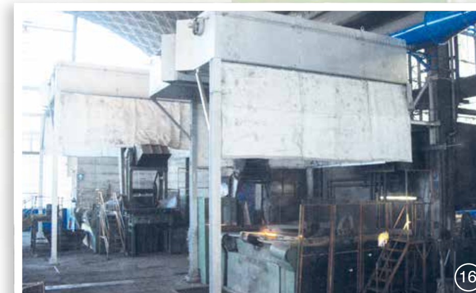
Cappe per forni elettrici per fusione ghisa / Suction hood on electric kilns for cast iron
